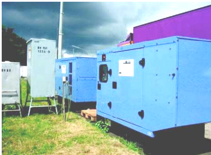
Hình 12.11: Máy phát điện.
